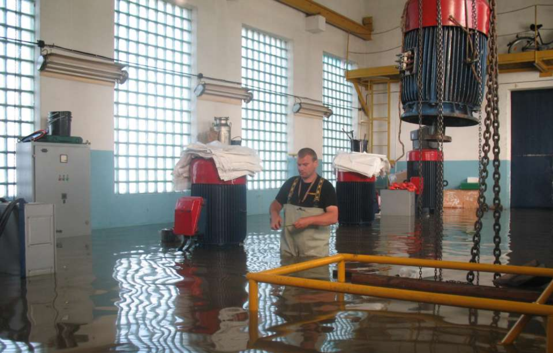
Dobrzyków II - maj 2010 - hala silników pomp
