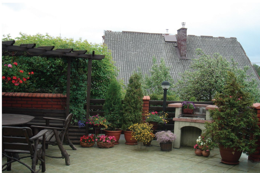
Uszkodzone wyroby azbestowe w bezpośrednim sąsiedztwie
