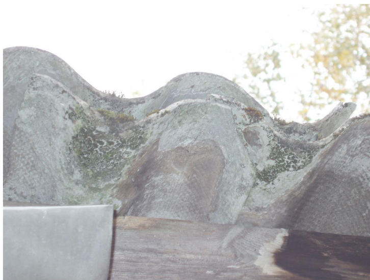
Uwalnianie się włókien azbestowych z uszkodzonych płyt dachowych
