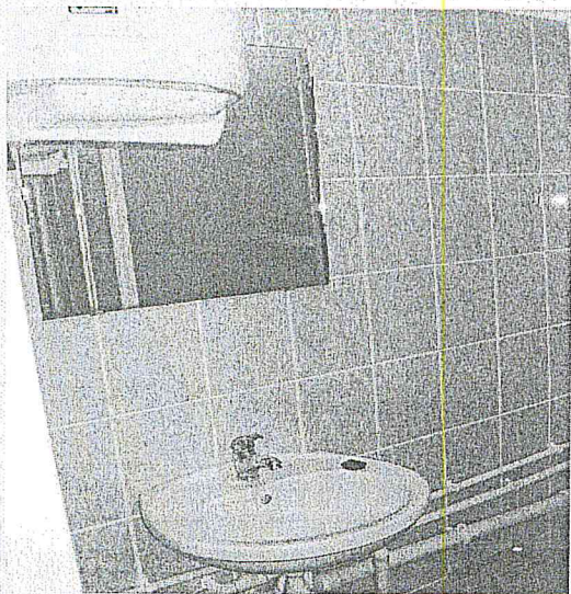
Łazienka (podgrzewacz wody, umywalka, toaleta).
